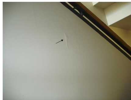
Figure 3: Détection visuelle d'un décollement
