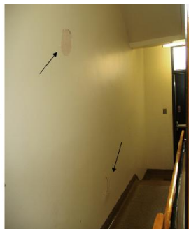
Figure 2: Détachement d'enduit de plâtre d'un mur
